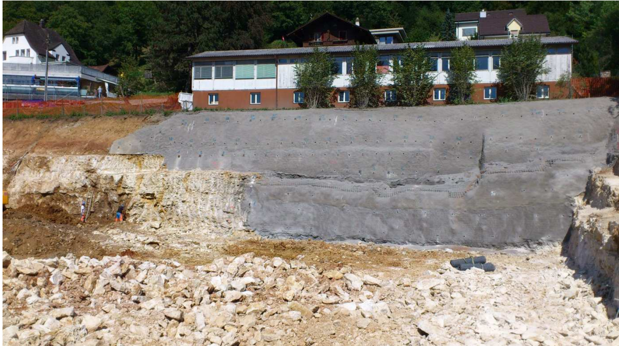
Bild 3: Wand Nord, Aushub zu ca 2/3 erstellt. Im Bereich rechts war aufgrund der mächtigeren Lockergesteinsdecke und der starken Verwitterung des Kalkfels die Nagelwand mit bis sechs Ankerlagen auszubilden.
