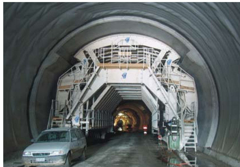
10 | Das Innengewölbe war ein Bestandteil der Innenausbauarbeiten. The inner lining was part of the interior finishing.
