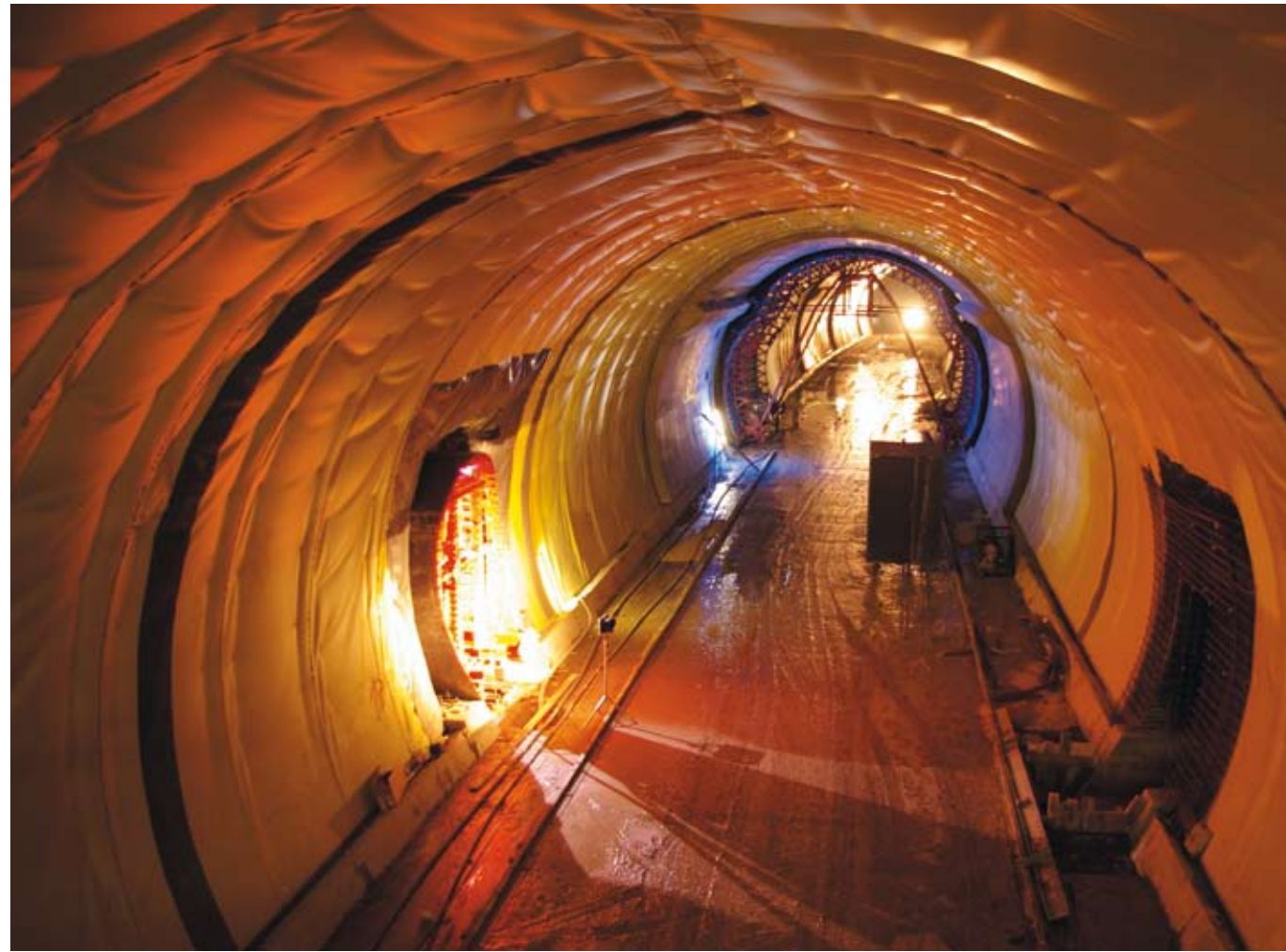
9 | Als Abdichtung wurde eine PVC-Folie mit einem aufkaschierten Vlies verwendet. For waterproofing a PVC sheet with a non-woven textile laminate was selected.
