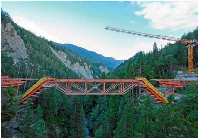
Fig. 6 Lehrgerüst mit 6 m hohem Fachwerk-Einhängeträger. Falsework with 6 m deep truss girder. (© P. Vonow)
