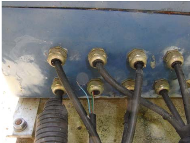
Bild 13 A19 GR, Hangsicherung Arschella
