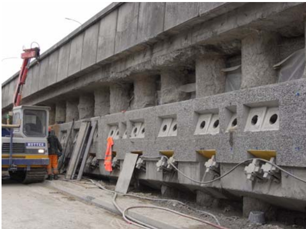
Unten im Bild Köpfe der bestehenden Anker mit spezieller Vorrichtung zum Schutz vor herausschiessenden Ankerteilen.
