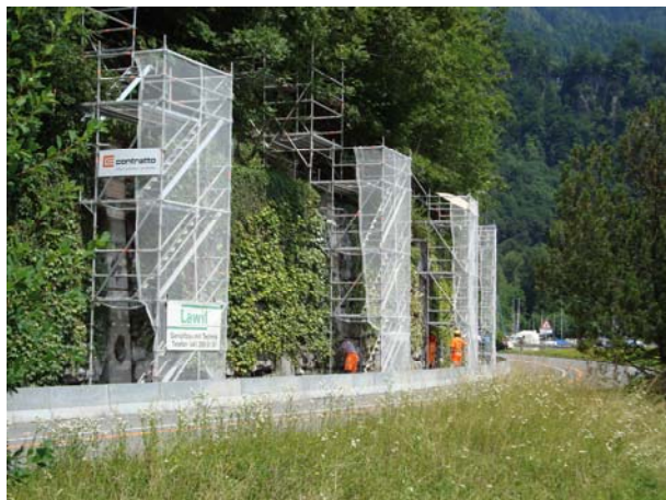
Detaillierte Überprüfung. In ausgewählten Querschnitten werden Anker der vertikalen und horizontalen Riegel untersucht.
