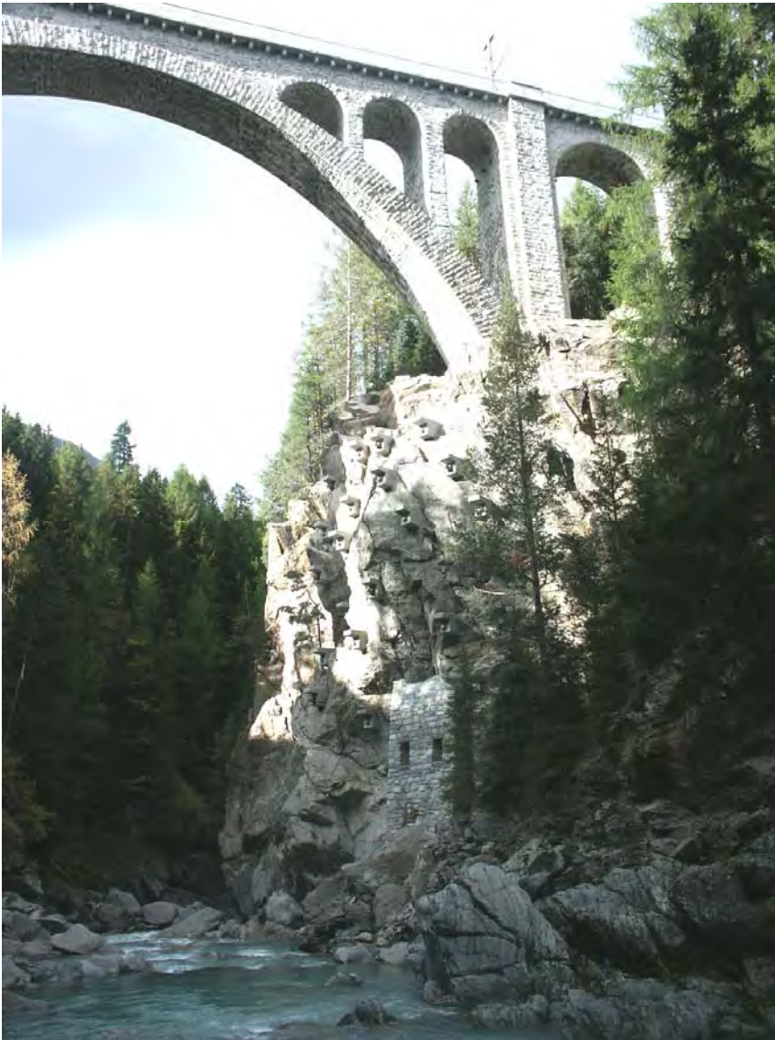
RhB Innviadukt Cinuos-chel, Felssicherung Kämpfer Zernez. Vorgespannte Felsanker auf Einzel-Widerlagern und mit Natursteinen verkleideter, verankerter Stütz Pfeiler am Wandfuss.
