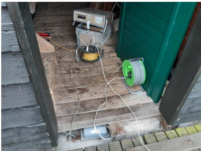
Das Registriergerät für die Erschütterungsmessungen konnte im Bootshaus installiert werden. Ein Geofon wurde im Bootshaus auf dem Betonsockel unter der Türschwelle installiert.
