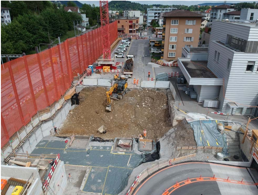
Schutzgerüst über gesamte Baugrubenlänge erstellt. Transportwasserleitung freigelegt, an Rühlwand aufgehängt und mit Holzverkleidung geschützt. Aushub Bauetappe 1 mit verankerter Rühlwand gegen die Gleise.
