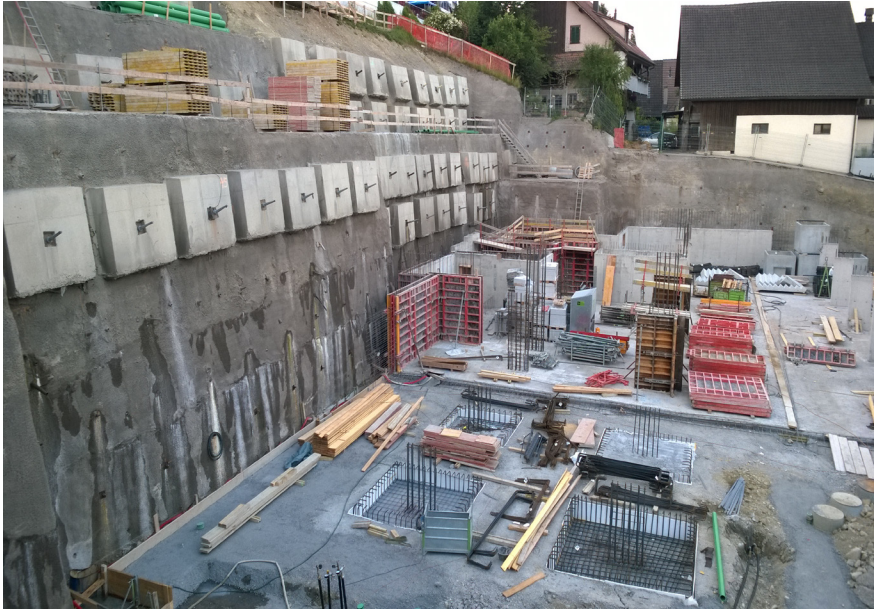
Ausgeführte Spritzbetonwand mit vorgespannten Anker im oberen Teil und ungespannten Anker im unteren Teil der Wand
