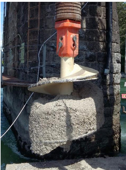
Durch den Bohrvorgang frisch gebrochene- und pulverisierte Komponenten des Hauptmuschelkalks bilden eine kompakte Masse.
