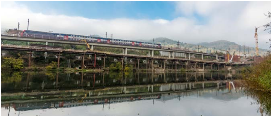
Ansicht an Hilfsbrücke. Foundation mit 2 ROR-Pfählen pro Joch. Verankerte Widerlager dienen zur Kraftabtragung der Horizontalkräfte quer zur Hibü.
