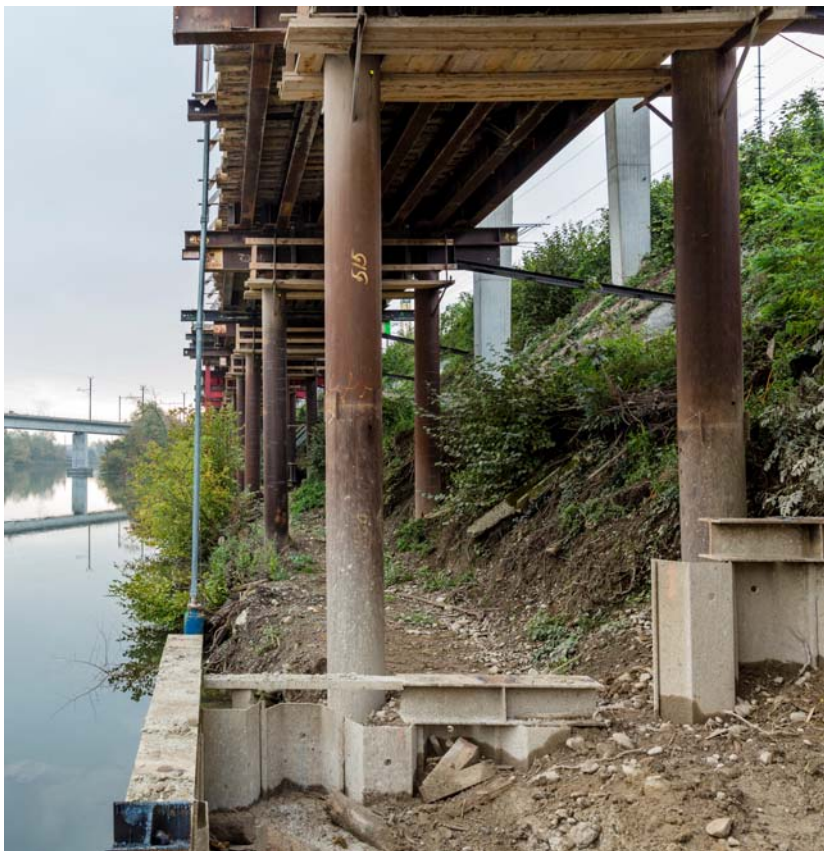
Untersicht der Hilfsbrücke mit ROR-Pfahlfundation mit Verstrebung an verankerte Widerlager zum Abtrag von Horizontalkräften. Im Vordergrund Spundwandkasten für Pfeilerbaugrube des neuen Lehnenviadukts vor Aushubbeginn. Links die Limmat.
