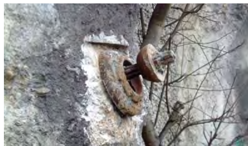
Aufgrund von Korrosion gebrochene Anker
