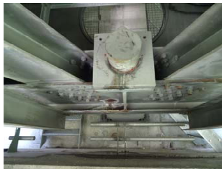
Bremsanker Kopf. Die Ursache für die Rostspuren in Bildmitte wurde gesucht. Im Schutzrohr hat sich Wasser aufgestaut. Eine Öffnung wurde angebracht.
