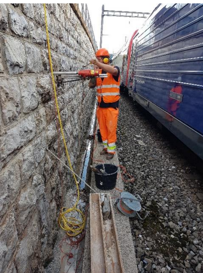
Kernbohrung zur Erfassung der Mauertiefe und Entnahme von Probestkörpern zur materialtechnischen Untersuchung.
