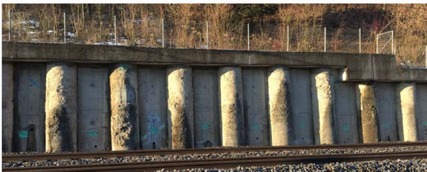
Bestehende aufgelöste Bohrpfehlwand (Typ C) mit Tragsicherheitsdefiziten im hohen Bereich.
