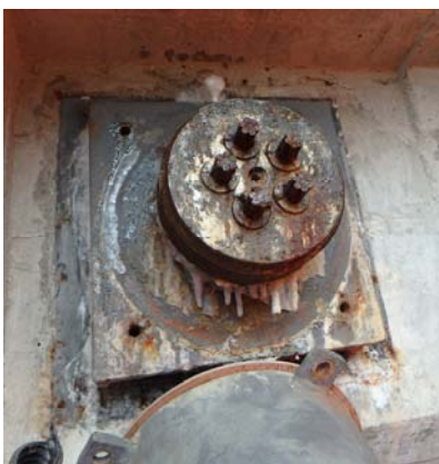
Kopf und Litzen mit viel Oberflächenrost. Kalkablagerungen auf Ankerplatte.
