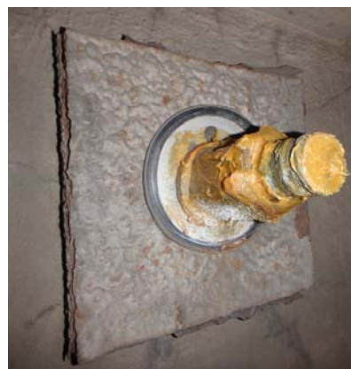
Ankerstab, Fettbeschichtung, Gummidichtung i.O. Farbbeschichtung der Ankerplatte blättert ab.
