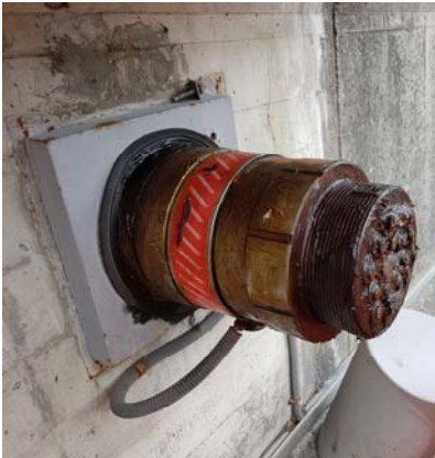
Messanker, guter Zustand von Fett, Litzen, Keilen
