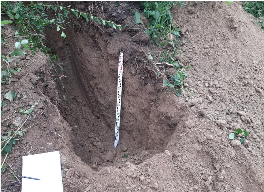
Baggerschlitz in der unterwasserseitigen Dammböschung. Das locker gelagerte, stark sandige Dammschüttmaterial kommt zum Vorschein. Zur Beurteilung der hydraulischen Durchlässigkeit wurden Materialproben entnommen und im Erdbaulabor die Kornverteilung bestimmt.
