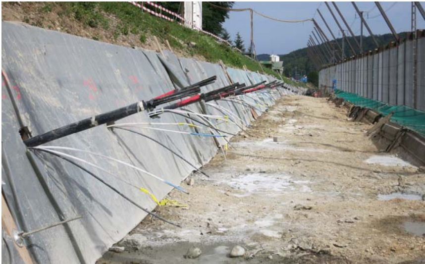
Ansicht Richtung Basel mit Bohrplanum, erstellten Ankerwiderlagerriegeln und eingebauten Vorspannankern (noch nicht gespannt). Talseitig des Bohrplanums ist das Schutzgerüst ersichtlich. Das Schutzgerüst wurde in 20 Nachteinsätzen erstellt. Die alte Landstrasse (bergseitig der Böschung) dient als Baupiste, Umschlags- und Installationsplatz.
