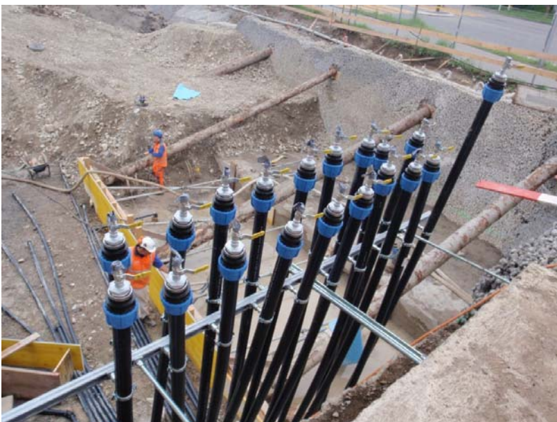
Die Zuleitungen der Infiltrationsbrunnen wurden unter der Bodenplatte des Neubaus eingelegt und seitlich hochgezogen, sodass die Bauverzögerungen kurz gehalten werden konnten und auch nach dem Bau der Bodenplatte die Infiltration des Oxydationsmittels möglich war.
