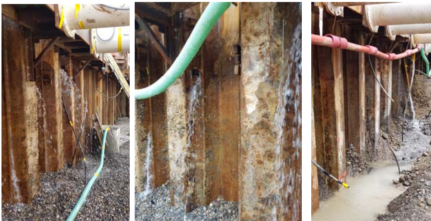
Oberflächliche Spundwandschlossverluste werden in Sickerschicht gefasst.
