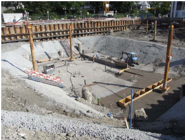
Baugrubenaushub, Kernaushub für die Erstellung der Spriessplatte. Entspannung des Grundwassers mittels Filterbrunnen (braune, überstehende Rohre).
